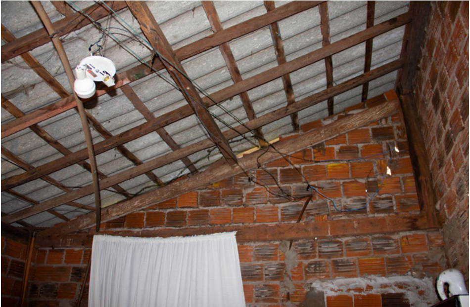
Figura 08 - Telhado e fiação elétrica exposta
