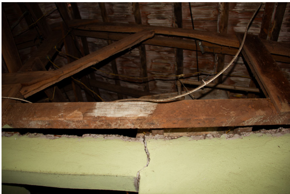
Figura 10 - Problema estrutural da viga cedendo
