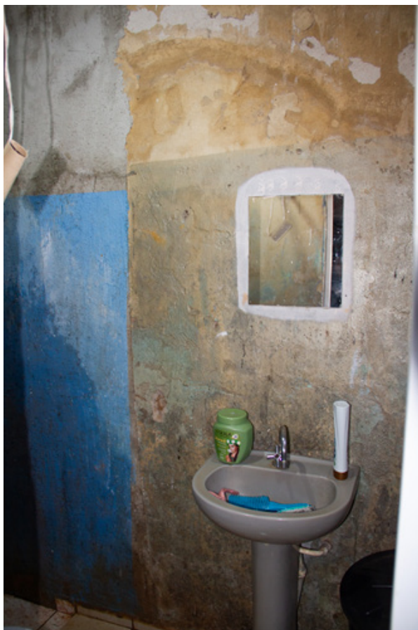
Figura 09 - Banheiros com mofo e ventilação inadequada
